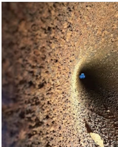
Rura przed oczyszczeniem
